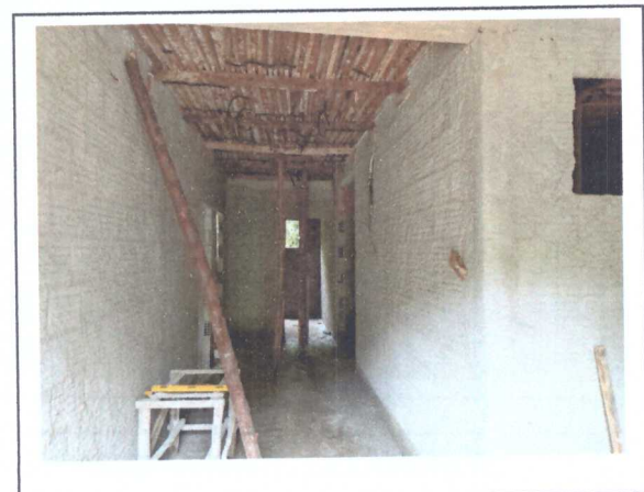
DEFORMA DA LAJE DO 2º PAVIMENTO
